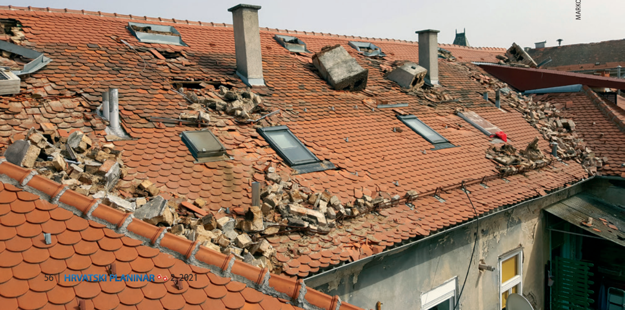
Jedno od brojnih oštećenih krovovišta
