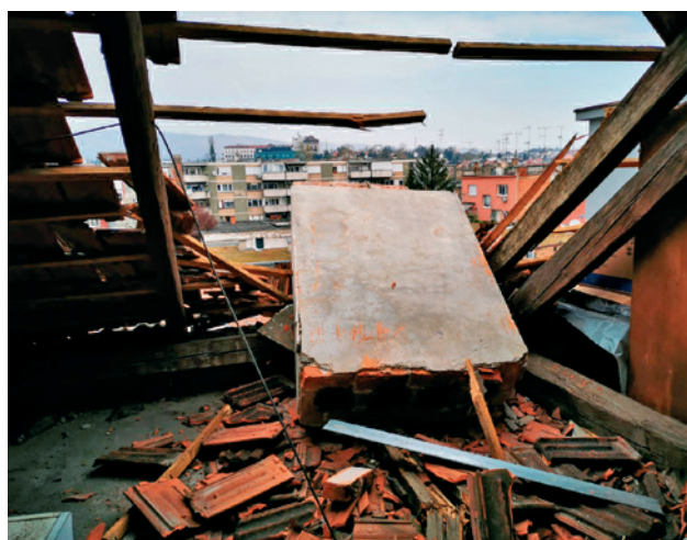
Jedan od brojnih srušenih dimnjaka
