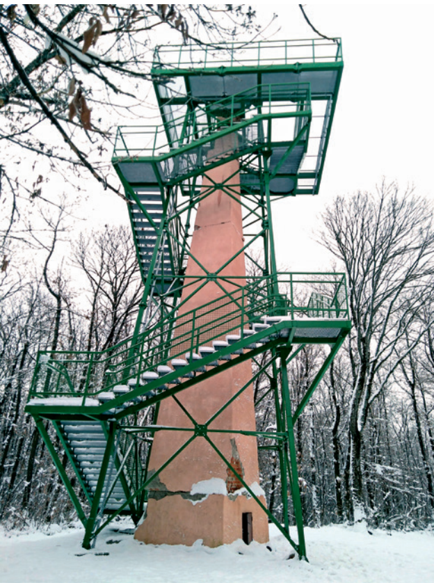
Raspucana geodetska piramida nakon potresa
